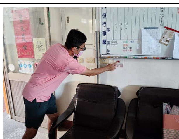
內容說明：防災設備-緊急通報按鈕直接連線轄區派出所
