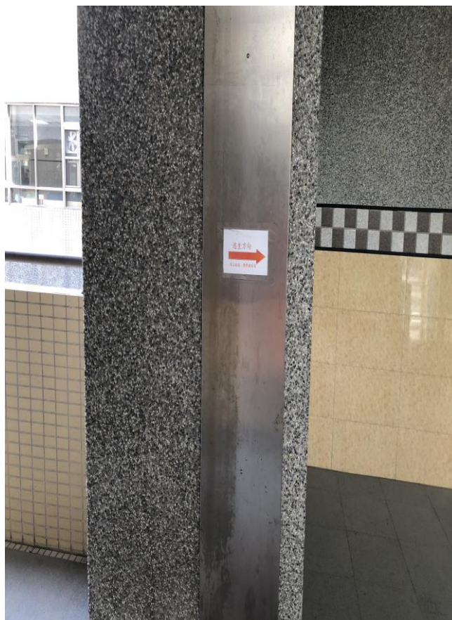
疏散方向指示標誌
